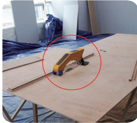
목재가공용 동근톱 날접촉방호덮개 설치
