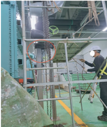
이동식비계 작업발판을 밀실하게 설치하지 않아 떨어짐 위험
