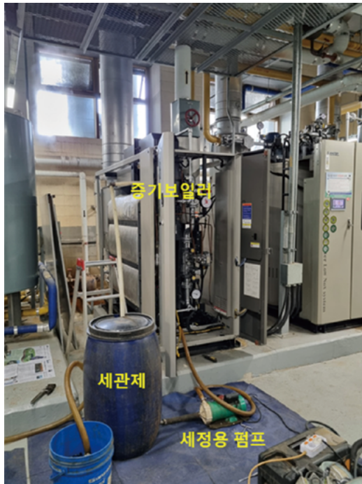
보일러실 내부 전경
