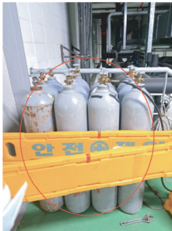
질소를 사용하여 배관 기밀시험 후 질소 배출 시 질식 위험
